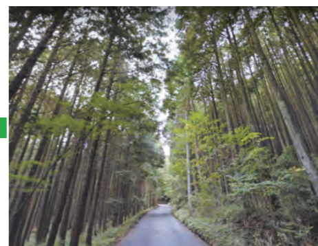
▲市道高里千万町線の作業前 電線に枝がかかっている、見通しも悪い
