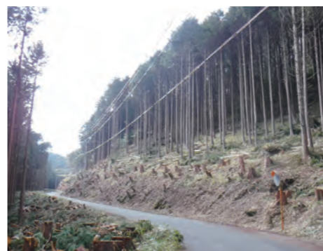
▲市道高里千万町線の作業後 電線に障害物がなく、見通しも良くなった
