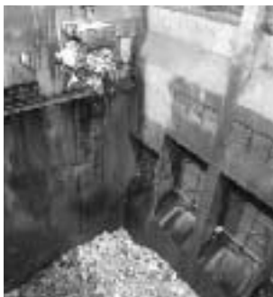
搬入したごみは「ごみピット(写真)」に貯め、クレーンで攪拌してから焼却炉へ投入します。ピットは300トンのごみを貯めることができます。通常は1つの焼却炉を使ってごみを焼却していますがピットが1つ以上になると焼却炉を2つ使います。
