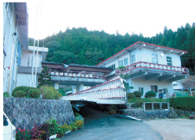
吹き飛んだ協和小学校の屋根
