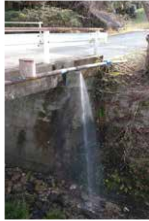
▲本市で発生した漏水
