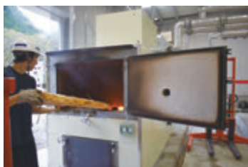
木質バイオマスボイラー
