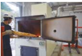
木質バイオマスボイラー
