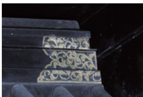
▲不自然に切断された金具(宮殿奥側右側面)
