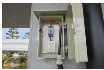
非常用コンセント
