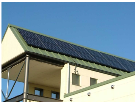
八名こども園の屋根に設置されている太陽光パネル
